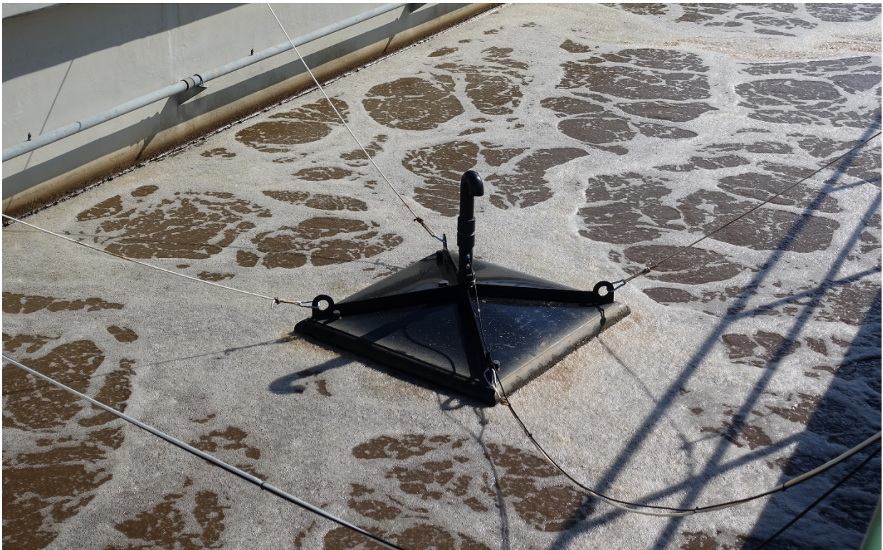
Abbildung 1: Beispiel Messhaube in Biologiebecken
