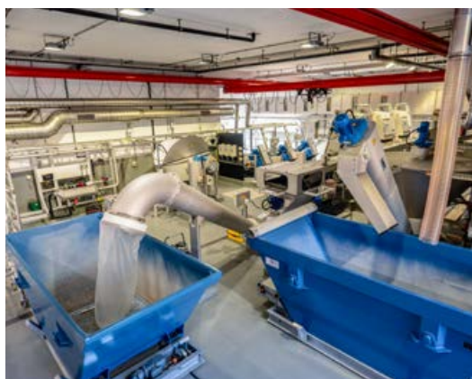
Einblick in die mechanische Reinigung der Abwasserreinigungsanlage (ARA) Flos.
