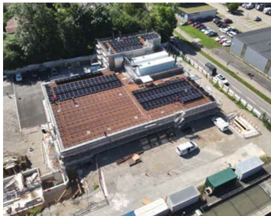
Die neue Photovoltaik-Anlage auf dem Gebäude der Sandfang- und Vorklärbecken, die seit Juli 2025 mit rund 300 Modulen Strom produziert.
