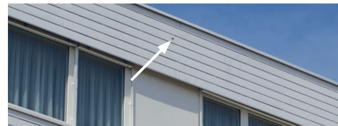
Nistkasten hinter Holzverschalung.
