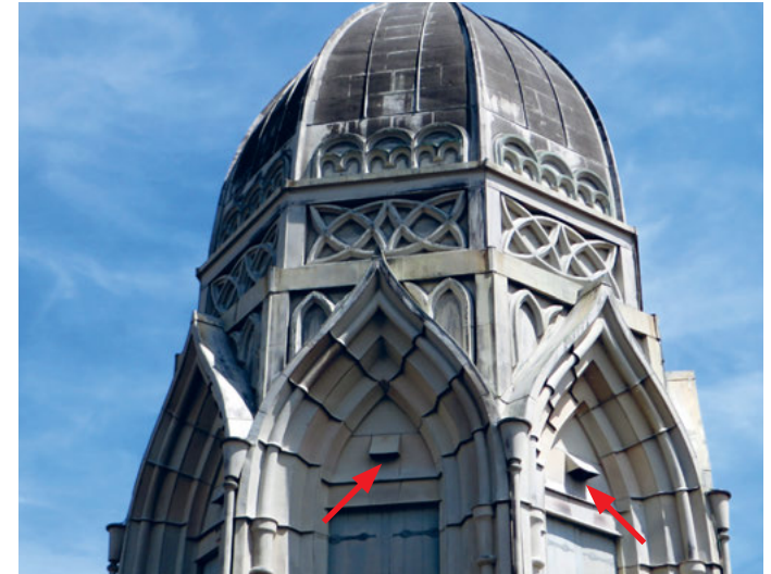
Im Kirchturm eingebaute Nistplätze.
