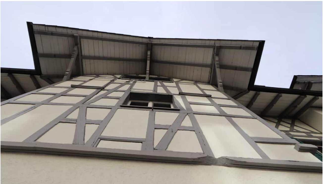
Abb. 60 Ansicht von Norden, Untersicht des Treppenrisalit-Fachwerks (1862). Fenster z.T. verändert, bauzeitliche Positionen durch verbleibende Rahmung ablesbar.
