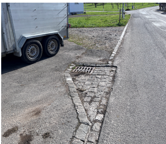
Strassenablauf auf Privatland
