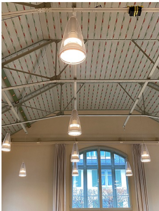
Bild 1: Nahaufnahme der aktuellen Leuchte
